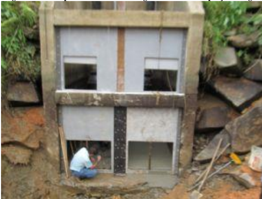
Figura 03 – Comportas de entrada de água no canal de captação de água de água bruta.
