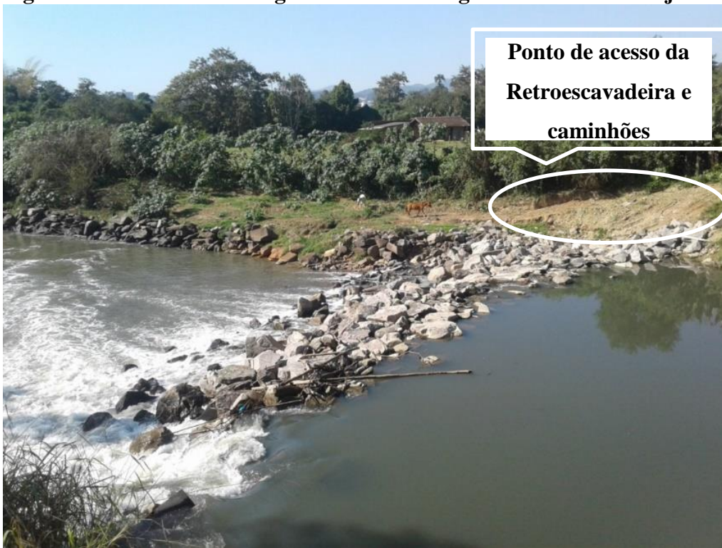
Figura 6 – Detalhe da barragem de nível e margem direita do rio Itajaí Mirim.
