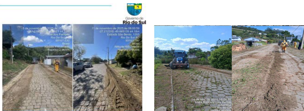
Figura 2 – Registros Fotográficos de vias públicas em péssimo estado de conservação.
