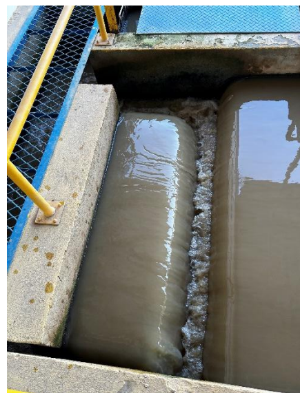
Figura 35 - Estação de tratamento
