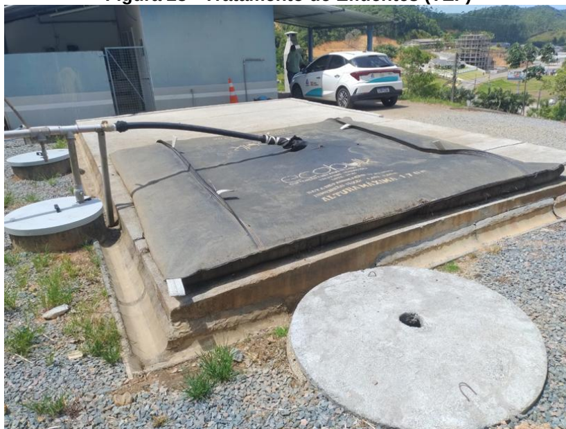
Figura 23 - Tratamento de Efluentes (TEF)
