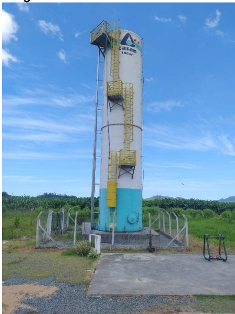
Figura 29 - Reservatório de 198 m³
