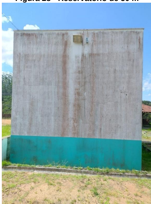
Figura 28 - Reservatório de 50 m³
