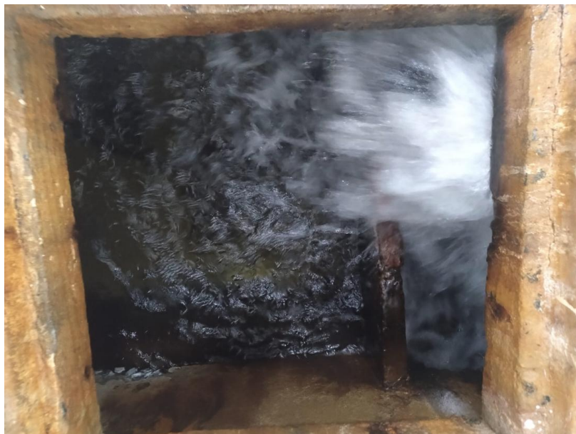
Figura 24 - Tanque de contato de 10 m 3
