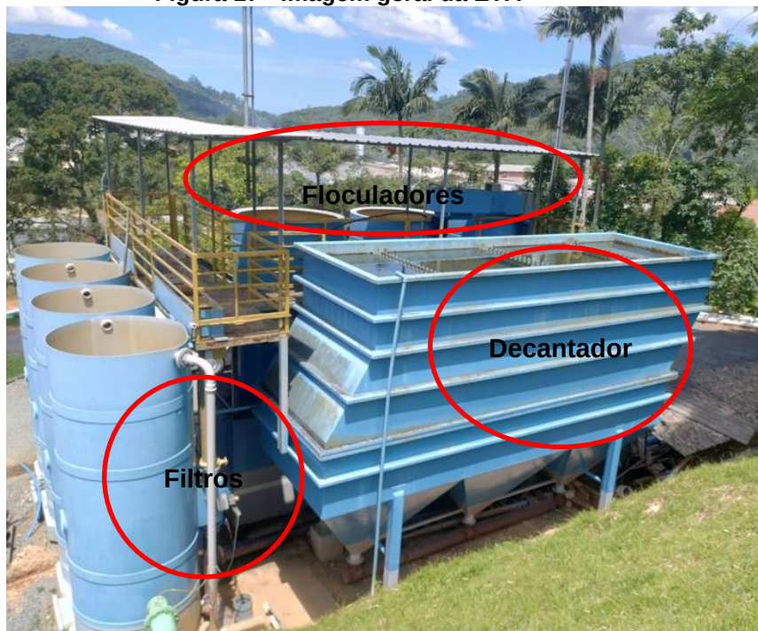
Figura 17 - Imagem geral da ETA
