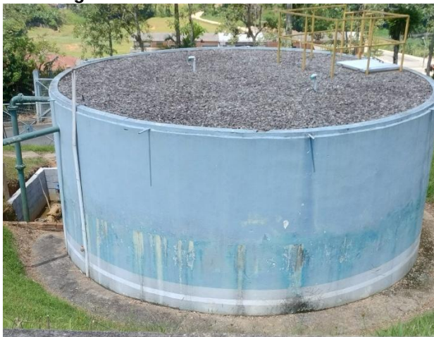
Figura 25 - Reservatório de 150 m³
