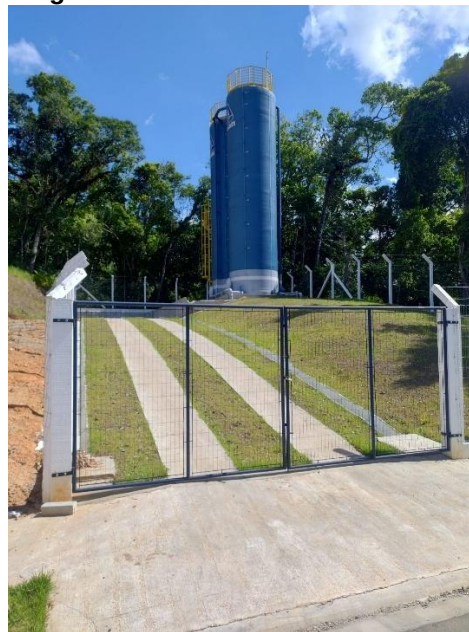
Figura 30 - Reservatório de 170 m³
