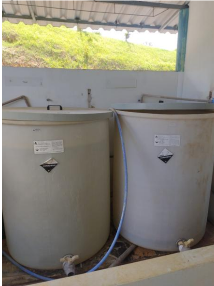
Figura 21 - Tanques de Cloro e Flúor
