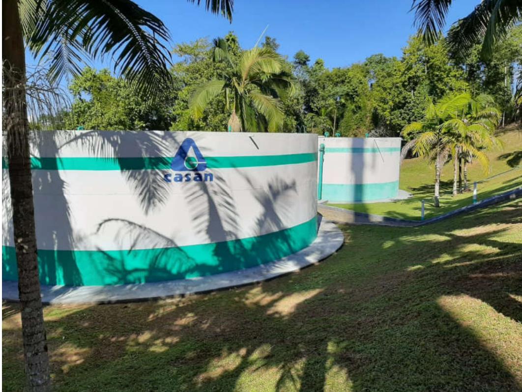
Figura 7. Reservatórios do SAA Rio Dos Cedros
