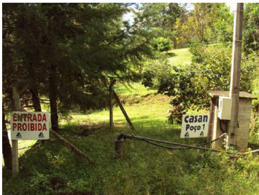
Figura 8. Captação de Poço Profundo
